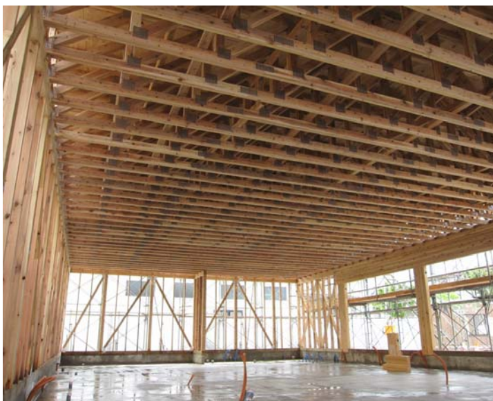
スギ2×4製材トラス梁
