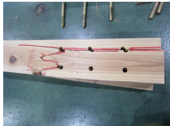
写真 3.5.5-14 10PDSP-4 木材の割れ
