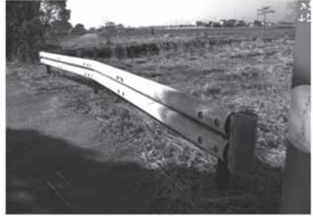
写真-7 信州型C種ガードレール
